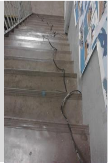
Imagen 02: un cable atraviesa peligrosamente una escalera
