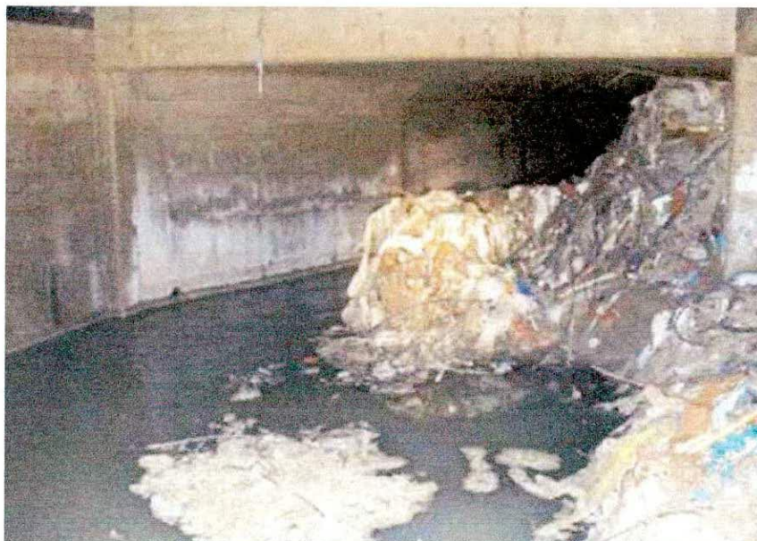
Figura 9.17. Obstrucción en el conducto de Las Perdices en el partido de Lanús
