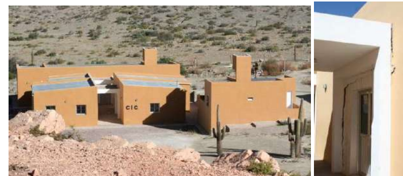
Gráfico 53|C6. Urbanización polar, comunidad Chalala. CIC, detalles de grietas. Fuente: fotografías propias, 2011 y 2012
