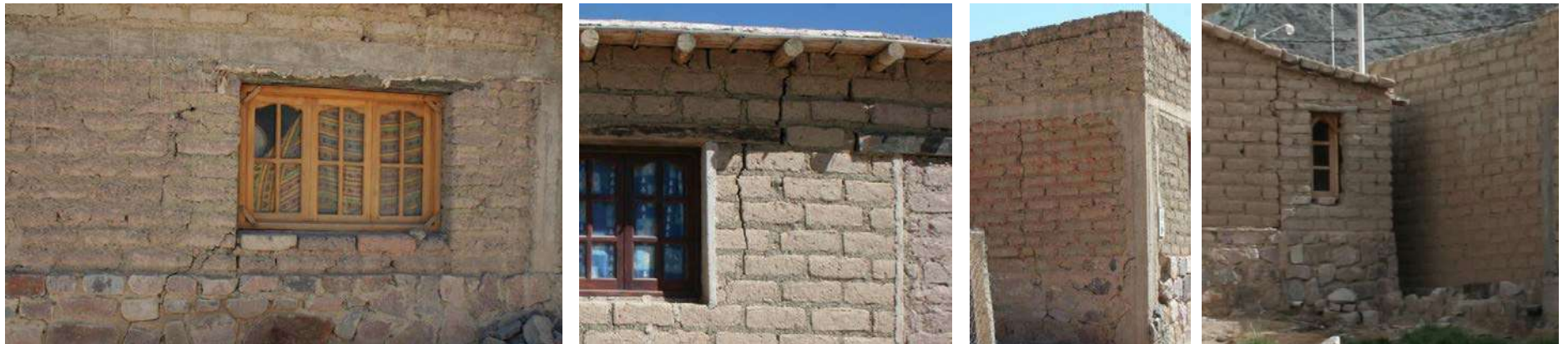
Gráfico 58|C6. Urbanización polar , comunidad Chalala. Grietas en construcción con o sin estructura de hormigos armado. Fuente: fotografías propias, 2011 y 2012.
