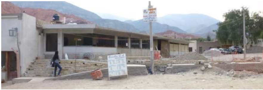
Gráfico 75|C5. Nueva terminal de micros en construcción con inversión privada. Fuente: fotografía propia, 2014.
